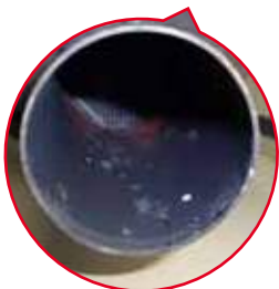
verrußtes Ansaugrohr – evtl. Filterelement undicht
